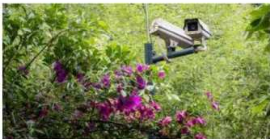
Elles seront installées sur un mât. © Illustration/D.R
